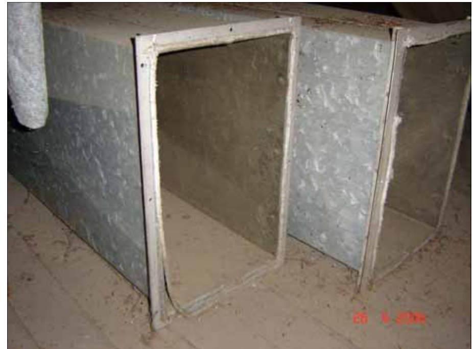
Lüftungskanal asbesthaltige Dichtung
